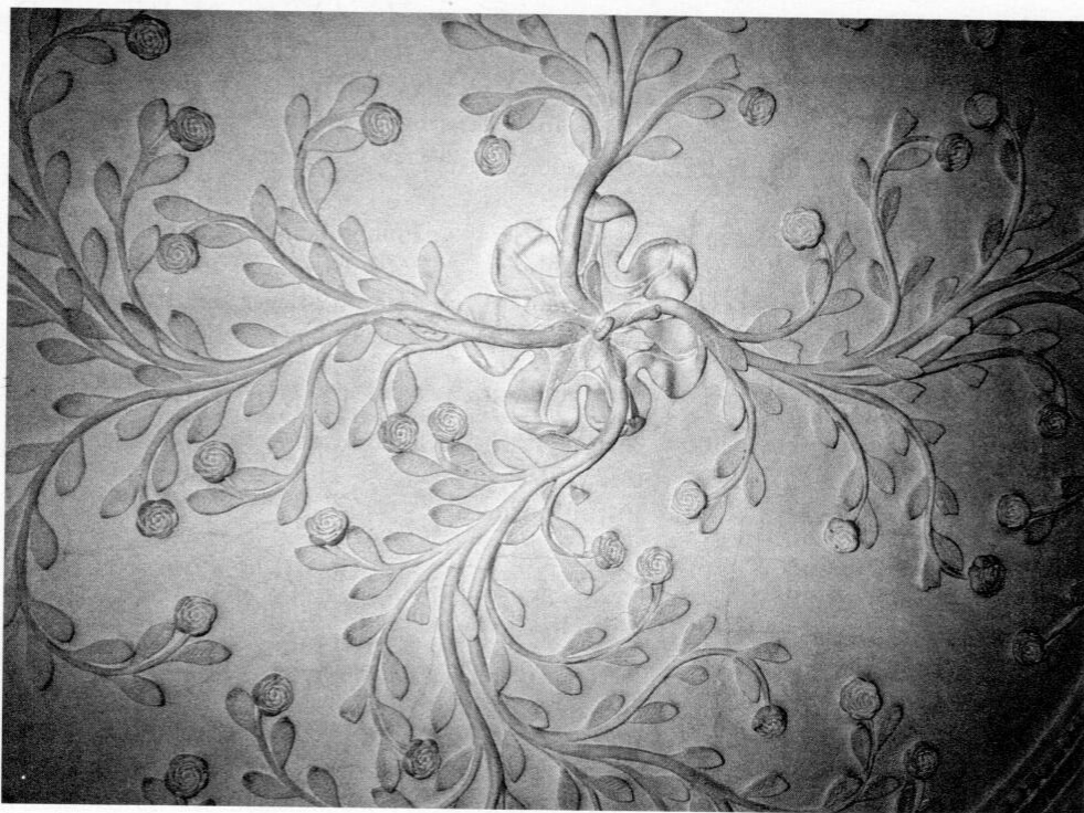
Abb. 3: Stuckdecke mit Rosenzweigdekoration im Treppenaufgang des Schlosses Schönbrunn.
