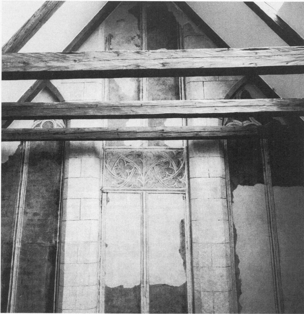
Abb. 6: Freising, Obere Domberggasse 5, mittlerer oberer Teil der Giebelwand von der 2. Dachwerksebene aus, nach erfolgten Reinigungs-, Verputz- und Konservierungsarbeiten.
