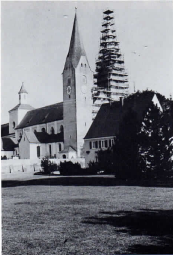
Pfarrkirche Kloster Indersdorf. Südturm und Westfassade sind eingerüstet, die Außenrestaurierung der Kirche – ohne Türme und Westwerk – ist abgeschlossen.
