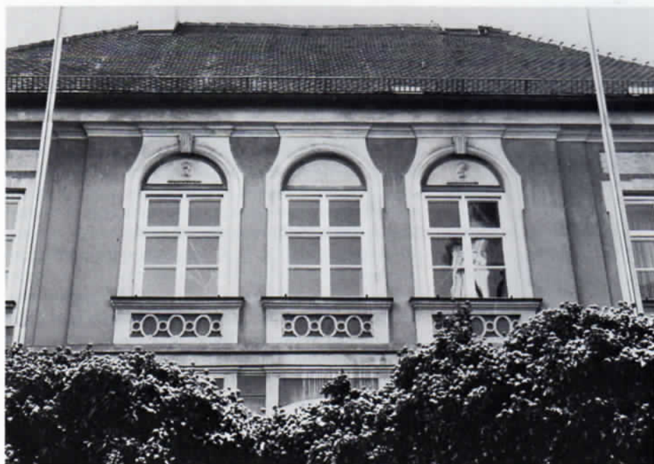
Das 1790 als kurfürstliches Kastenamt erbaute alte Dachauer Finanzamtsgebäude. In den Bögen über den beiden äußeren Fenstern sind zwei stark übermalte Porträtreiefs schwach zu erkennen. Zustand vor der Renovierung. Foto: Dr. Peter Dörner
