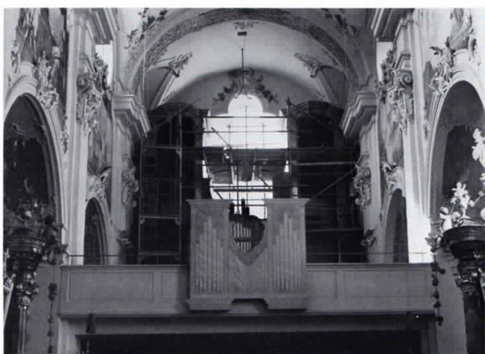
Pfarrkirche Kloster Indersdorf, Orgelgehäuse nach Abnahme aller Verzierungen und Ausbau der Orgel. An der Brüstung des Modell des Rückpositivs (Brüstungsorgel) für das II. Manual. Zustand September 1986.
