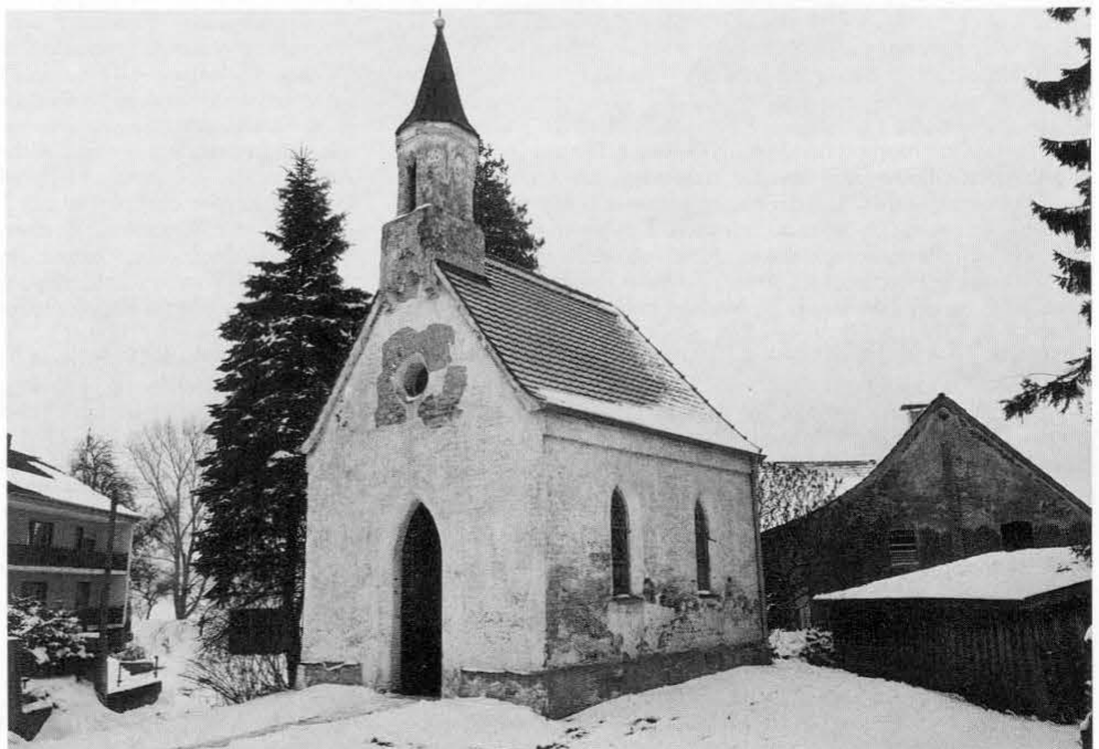
Kapelle St. Maria in Römertsbofen, Zustand vor der Renovierung. Foto: Alexander Zeh, Jesenwang
